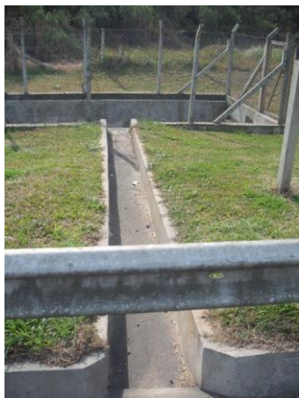
Figura 5 - Drenagem da rodovia escoando para o tanque de contenção (ao fundo)
