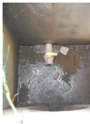
Figura 8 - Imagem do registro de saída do tanque de contenção
