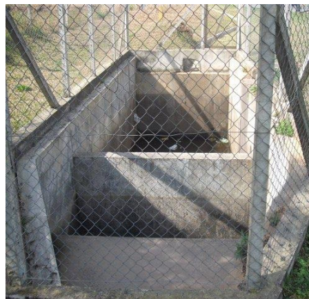
Figura 6 - Imagem de tanque de contenção instalada na BR-277, na divisa entre os municípios de Curitiba-PR e Campo Largo-PR
